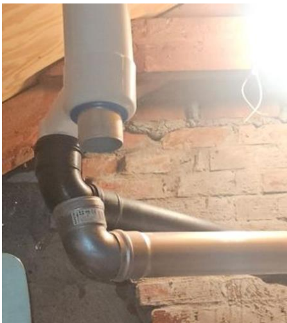
Losgeschoten afvoer van de CV op zolder; levensgevaarlijk vanwege de kans op koolmonoxidevergiftiging.
